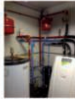
PAC Eau Eau (Geothermie)
